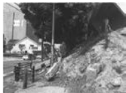
道路わきのフェンスが曲がりコンクリートが崩れたりしていた。KEEP OUTの文字もあった。
