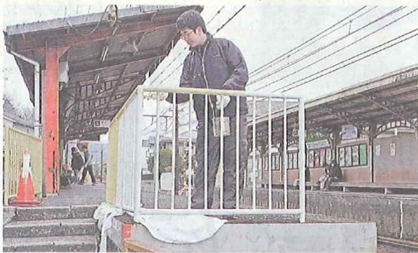
塗装がはげた手すりをペンキで塗り替える生徒 (京都市左京区・八幡前駅)
